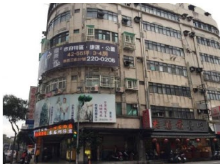
A 集賢大樓外觀磁磚剝落
